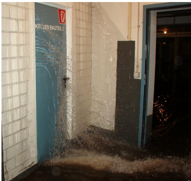
Schon bei wenigen Zentimetern Überflutungstiefe können Räume im Untergeschosse mit Wasser volllaufen: Hinter dieser Türe besteht höchste Lebensgefahr (Bild: Feuerwehr Freiburg)
